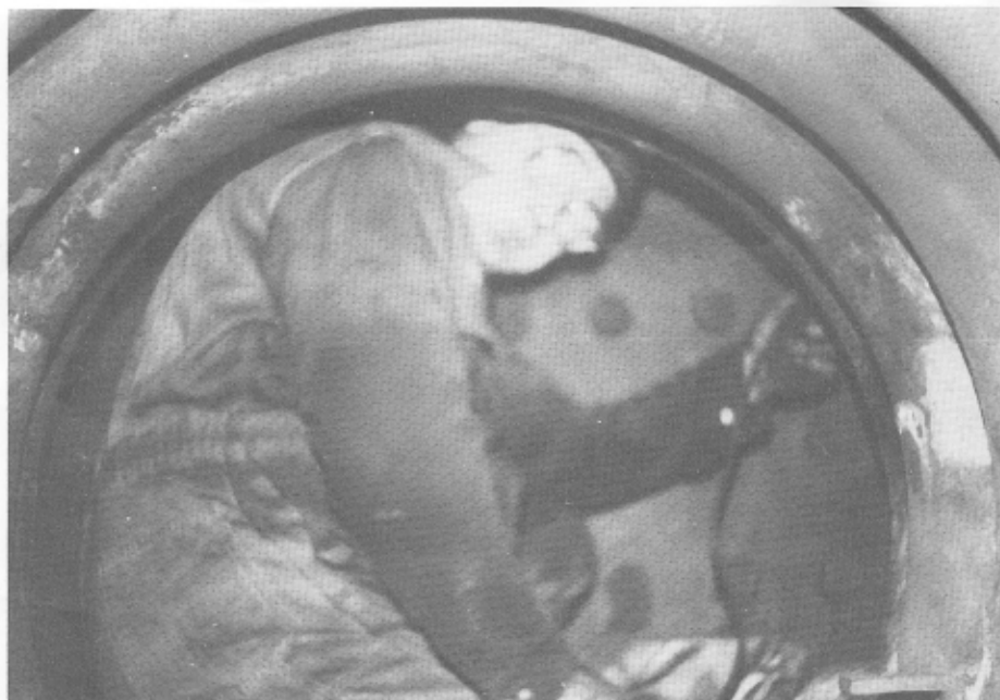
Det er trange forhold at arbejde under.
