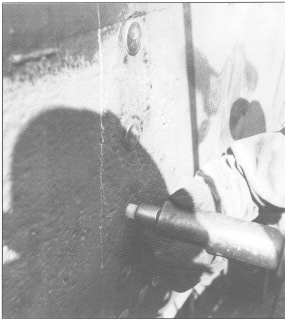
På billedet, der viser nitning på SIS »Skjelskør«, er den glødende nagle lige stukket igennem, og bearbejdningen med luftværktøj er begyndt.
